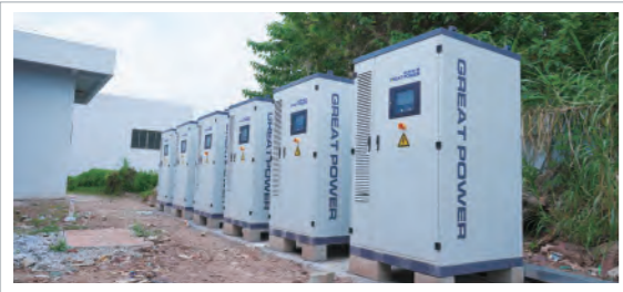
广州冷链园区1.29MWh分布式储能项目
