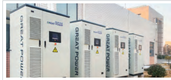
江苏宜兴860kWh储能项目
