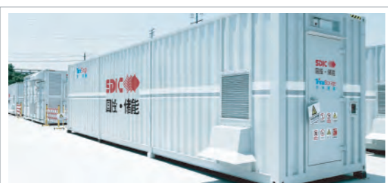
江苏DL工业园 80MWh 储能电站项目
