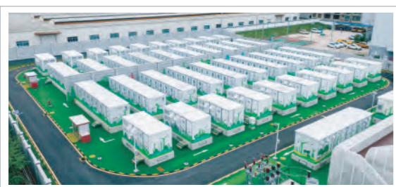
广西南宁 100MWh 储能电站项目
