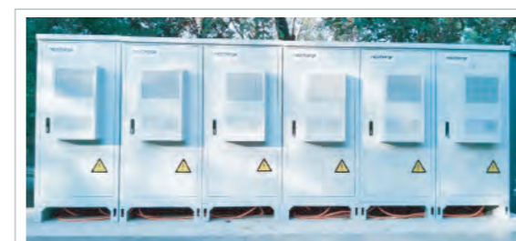
印度 2MWh 离网光储项目
