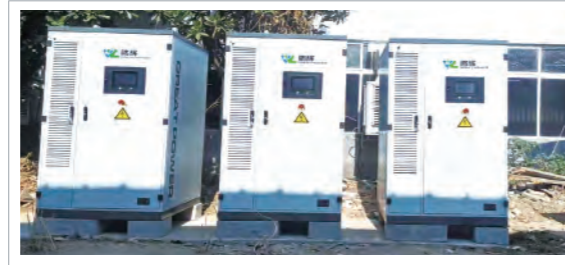
汝南裕信纺织1.5MWh分布式储能项目
