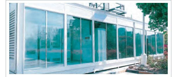
广西柳州上汽通用五菱 1MWh 梯次利用储能电站
