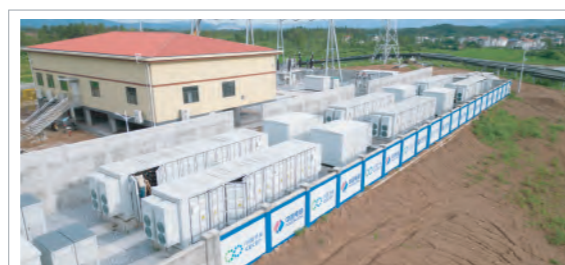
江西吉安 15MWh 农光互补项目
