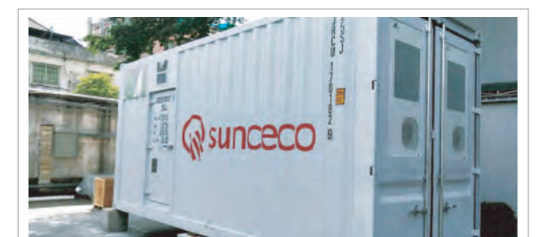
克罗地亚 1MWh 储能项目
