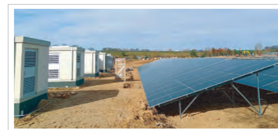
德国 16.77MWh 集装箱储能项目
